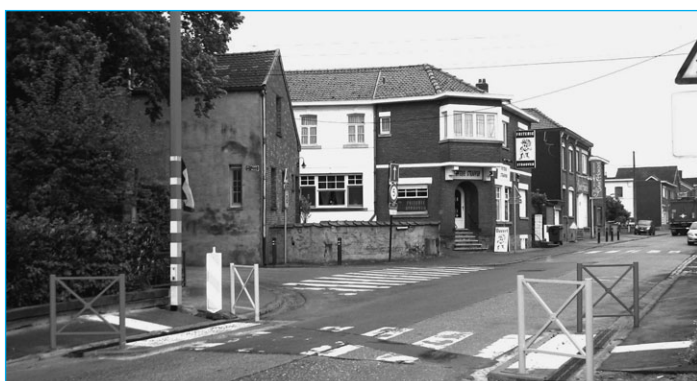
Réfection et égouttage des rues du Ruisseau et de Beaumont à Haccourt=>
